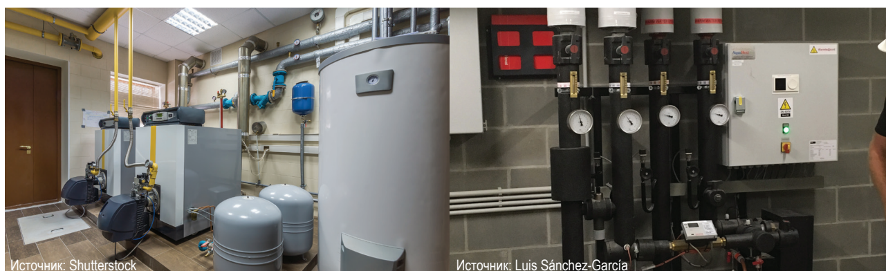
Фотография 5. Газовые котлы в газовой бойлерной (слева) и подстанция в здании в Бельгии (справа)
