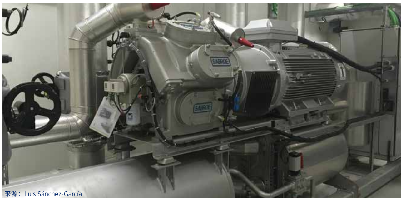
照片 3: 丹麦区域供热系统中的压缩式热泵
