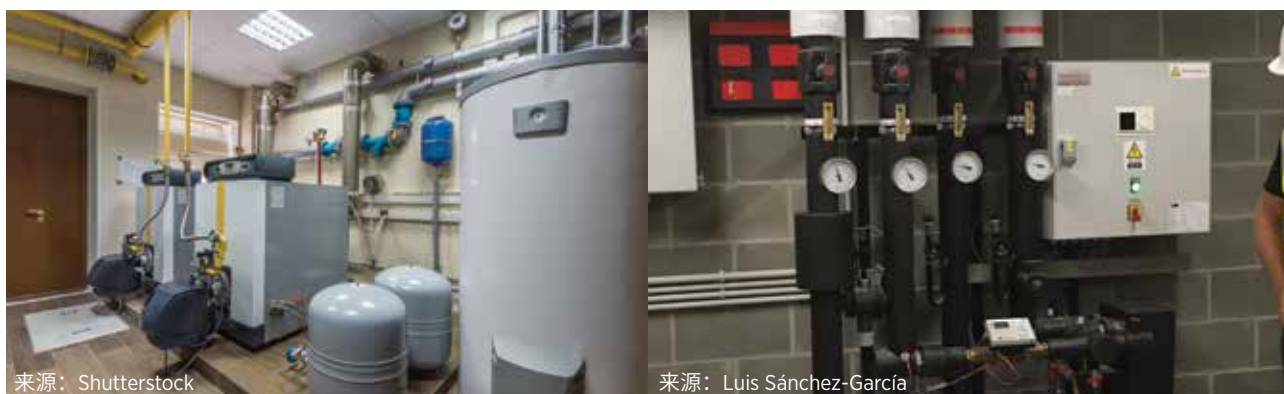
照片 5：燃气锅炉房中的燃气锅炉（左）和比利时某建筑中的换热站（右）
